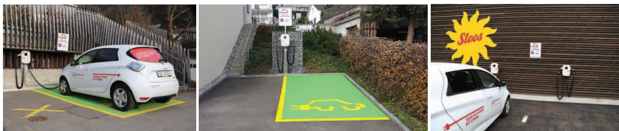
Die neu installierten Ladestationen (v.l.n.r.): Gersau, Steinerberg, Stoosbahnen.
